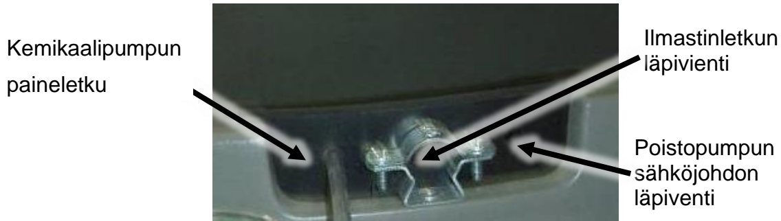
Kuva 14. Kompessorin ilmastinletkun läpivienti laitesuojasta prosessisäiliöön.
